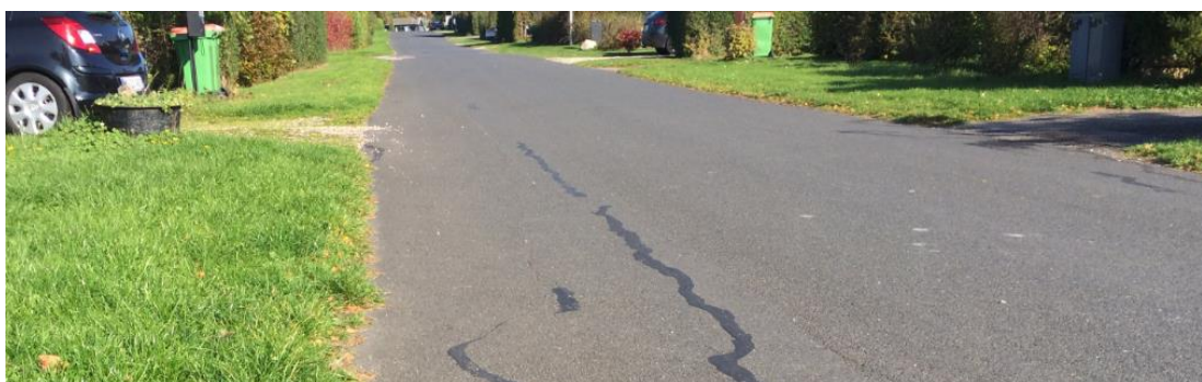
Foto 12: Hejrevej set mod nord. Langsgående krakeleringer. Græsrabatterne vokser ind i belægningens sider.
