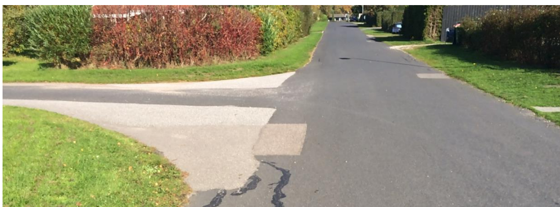
Foto 13: Hejrevej set mod nord. Dele af belægningen er udskiftet i krydset (lyse felter), hvilket kunne indikere tidligere problemer med opblødning/opkøring i svinget.
