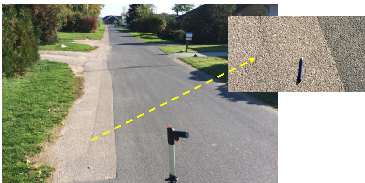
Foto 21: Rørsangervej set mod øst. De østligste ca. 120 m i nordlige side (tv) og ca. 30 m i sydlige side (th) er der i en bredde af ca. 90 cm foretaget belægningsudskiftning (fremtræder med lysere stenmateriale – opgravninger for forsyningsledninger?). Der forekommer også revner i de aldrende, udskiftede delarealer (indsat billede).
