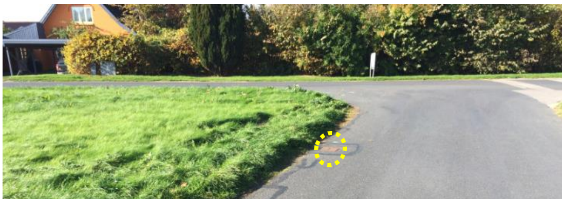
Foto 16: Hejrevejs østlige tilslutning til Bækkegårdsvej. I den sydlige side står græsrabatten højt og der er opstået en vandansamlende rende mellem asfalt og græsbevoksning, hvor vandet løber ned bagom afvandingsbrønden (gulmarkeret) og svækker belægningens yderside, så belægningen krakelerer.
