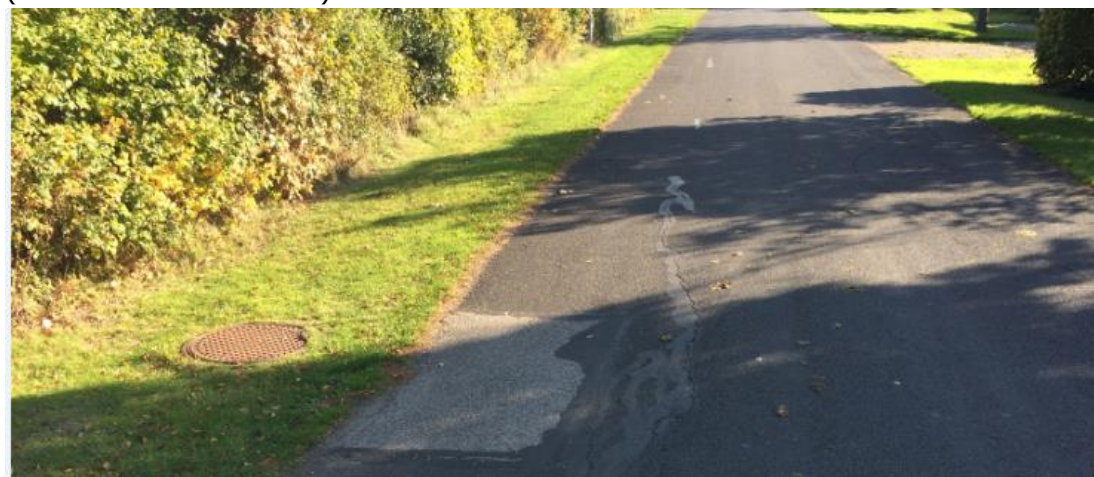
Foto 18: Udskiftet parti ved brønd. Det lappede areal udgør en lunke, som samler vand. Sætning muligvis pga. kollaps i underliggende rørføring eller brønd?
