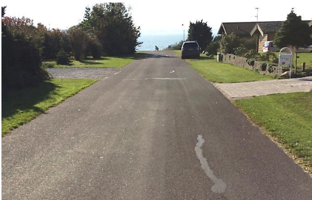
Foto 7: Bækkegårdsvej set mod syd, syd for Rørsangervej. Kun begrænsede revner på denne del.
