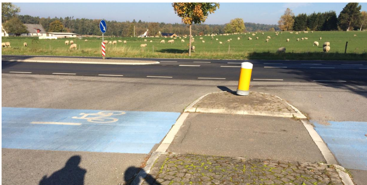
Foto 1: Bækkegårdsvejs udmundning ved Frederiksværksvej. Som det ses har den for nyligt gennemførte slidlagsfornyelse på landevejen ikke været fulgt op med samtidigt fornyet belægning i T-tilslutningen for Bækkegårdsvej.
