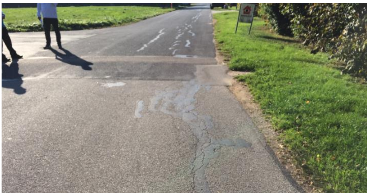
Foto 3: Bækkegårdsvej set mod syd ved tilslutning til Hejrevej (t.v.). Svagt punkt med mere omfattende krakelering i vejens højre side. På tværs ses også reetablering efter opgravning for afvandsbrønd. I den fjernere del ses det mere generelt udbredte slidlag med en del langsgående krakeleringer.
