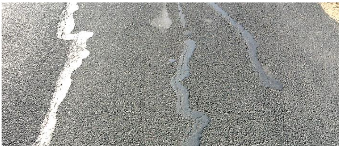
Foto 4: Revneforsegling holder ikke evigt. En stor del af de udførte revneforseglinger er begyndt at revne igen, hvorved der er fornyet risiko for vandgennemtrængning og efterfølgende skader
