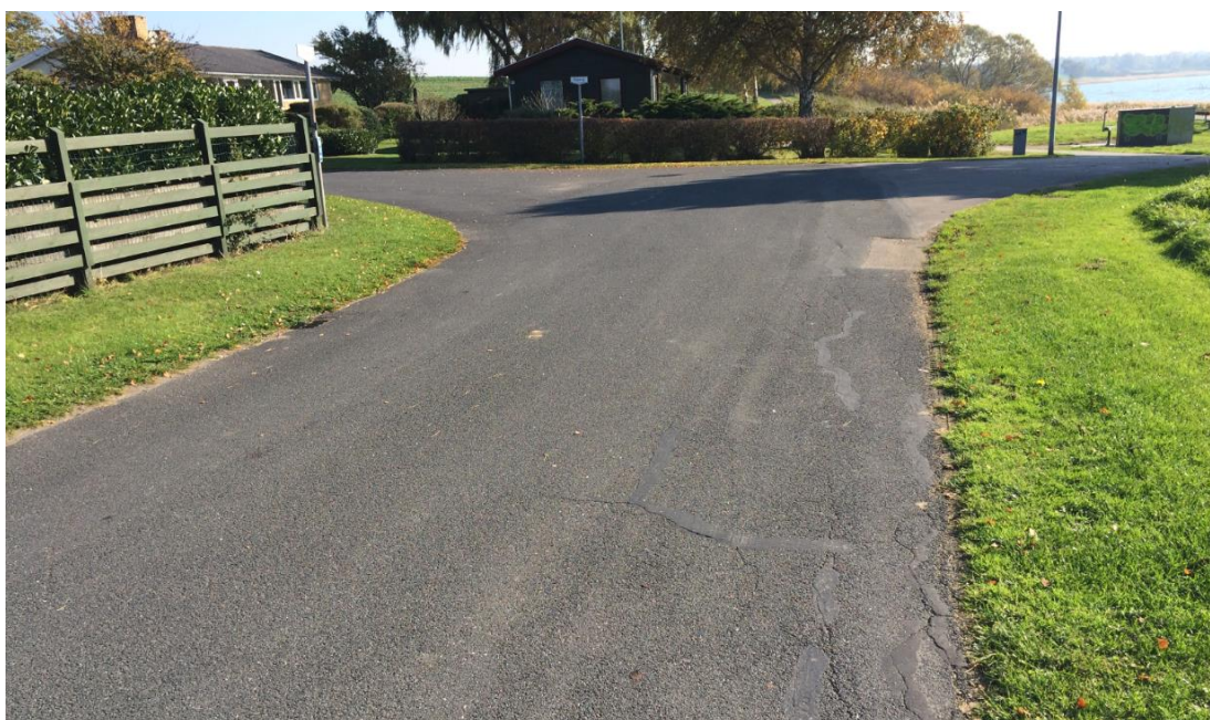
Foto 10: Søbreddens østlige ende. Krakeleringer i den sydlige side.
