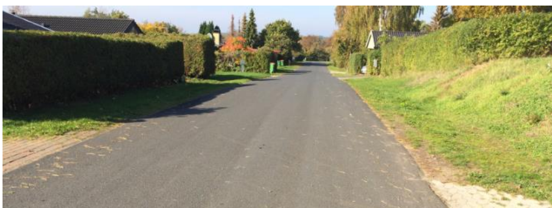
Foto 15: Hejrevejs nordlige "vinkel"-tilslutning mod Bækkegårdsvej set fra øst mod vest. Rimelig intakt belægning med relativt få krakeleringer/revner. Der ses en del trykmærker ca. ud for nr. 15, men ingen revner i denne anledning.
