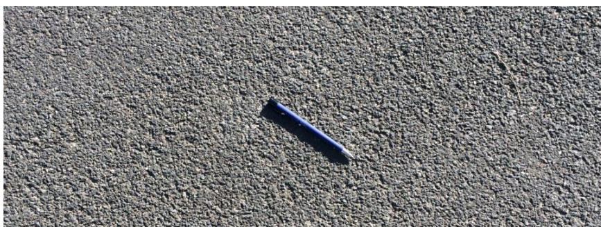
Foto 8: Close-up af belægningen. Grundet den høje alder har belægningen begyndende udtørring. Stentabet i overfladen er dog endnu meget begrænset.
