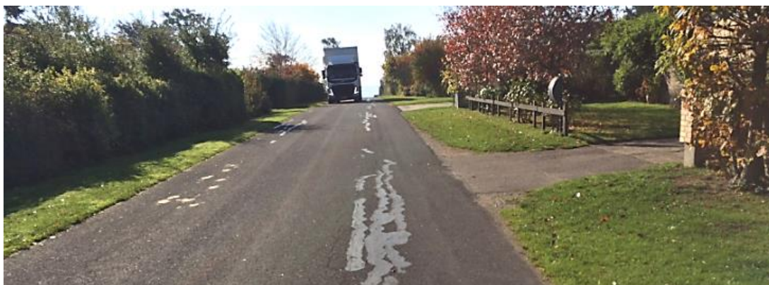
Foto 6: Bækkegårdsvej mellem Svanevej og Rørsangervej, set mod syd. Primært i vejens højre side ses omfattende krakeleringer, som i stort omfang er revneforseglet. Der ses dog også revner i venstre side. Bemærk også lastbilen, trods stille, lukket område.
