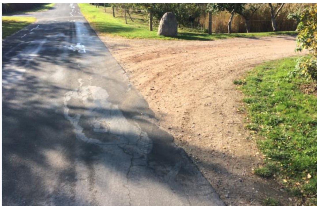
Foto 5: Vejbelægningen er omfattende nedbrudt og krakeleret på ca. 15 meter ud for indkørslen til rideskolen/hestestuderiet Bækkegården. Det formodes, at nedbrydningen i væsentligt omfang skyldes vrid og belastning fra de tunge betonelementtransporter i forbindelse med bygningernes opførelse/ombygning.
