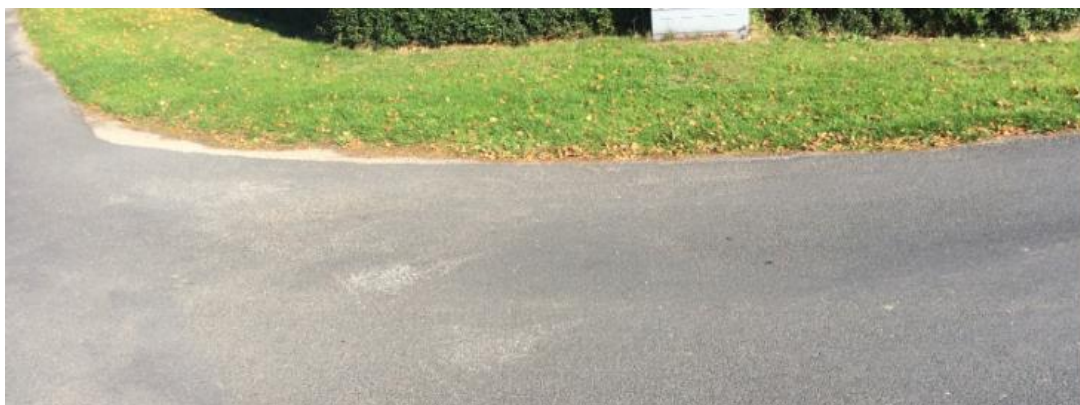
Foto 19: Højtænder bortslidt ved Svanevejs udmunding i Bækkegårdsvej. Disse bør friskes op, såfremt vigepligten ønskes fastholdt (alternativt alm. højre-vigepligtsregler).
