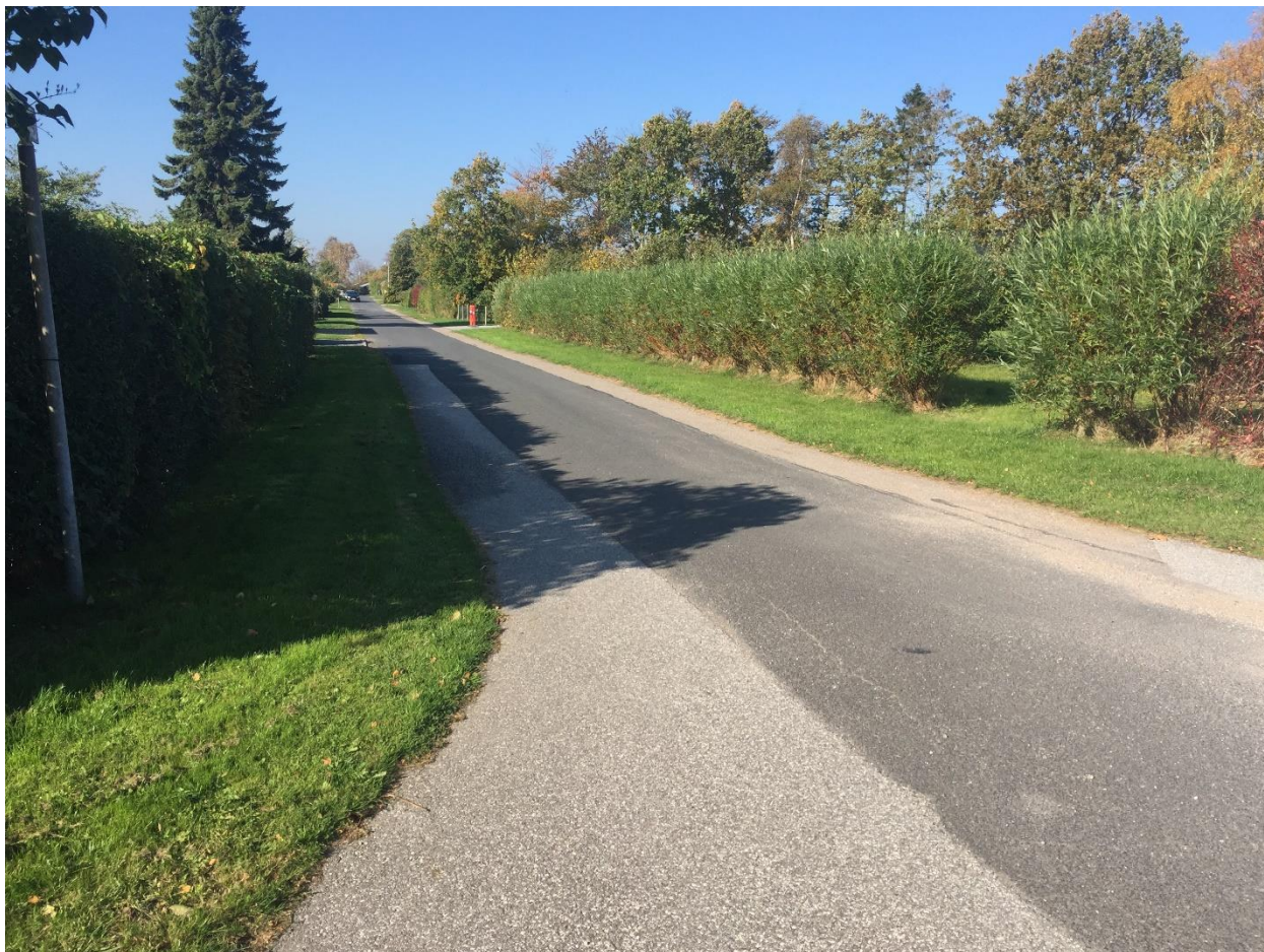
Foto 7: Rørsangervej/Hejrevej. Vandet strømmer ad Rørsangervej mod Hejrevej.
